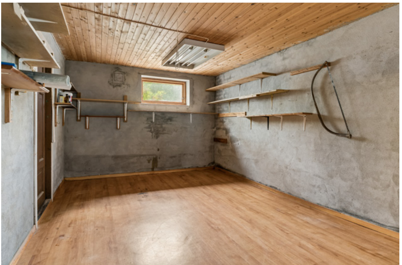
Kjellarbod med ubehandla betongpuss og veggmonterte trehyller til lagring.
